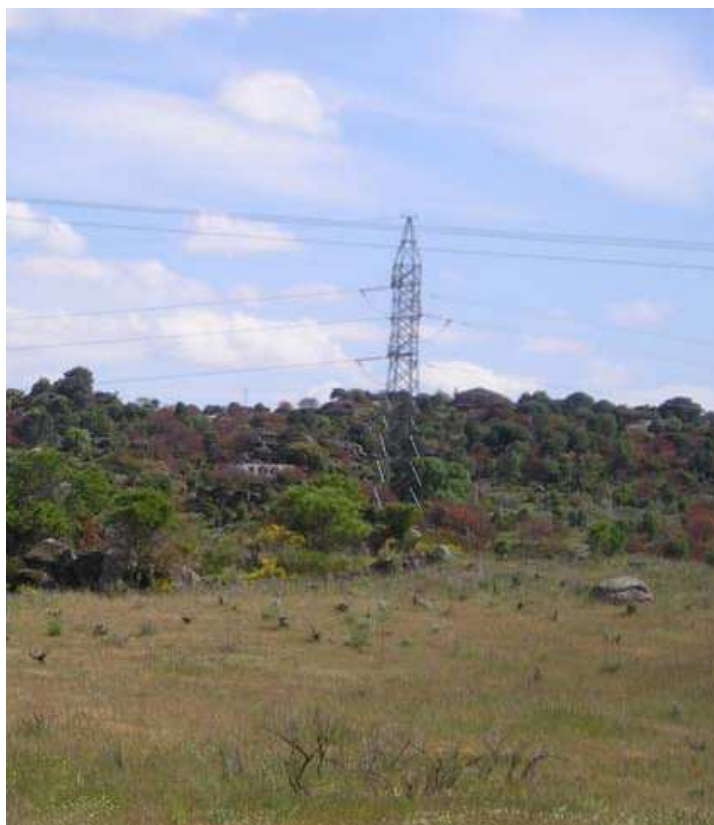
Imagen 11: Línea de 132 kV simple
